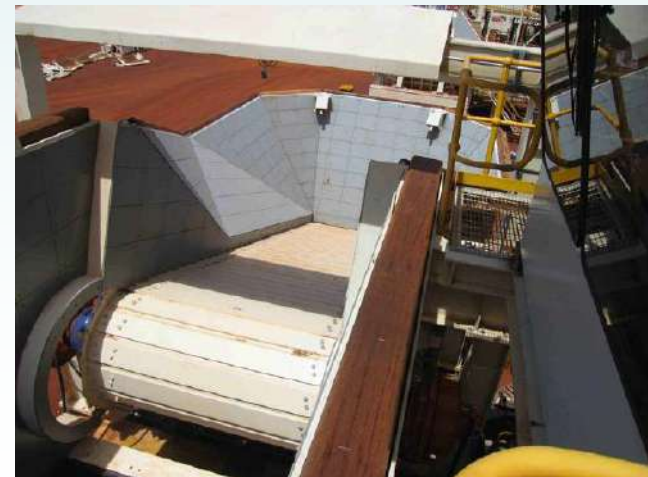
TTMS Apron Feeder
